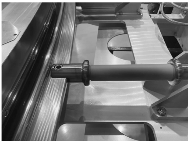
Рис. 8. Опорные изоляторы с запыленные углеродным слоем
