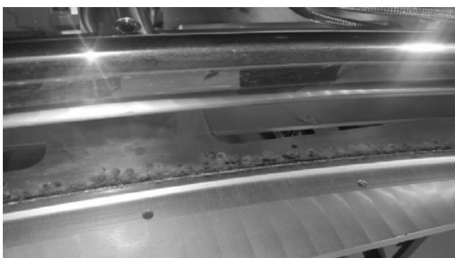
Рис. 7. Следы пробоев на опорной пластине дефлектора
