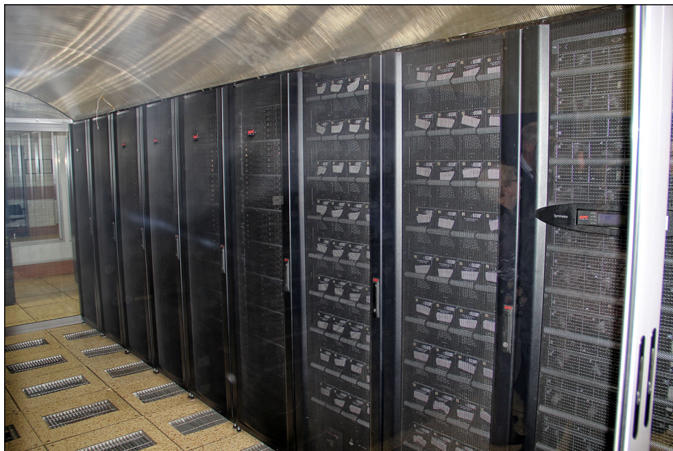
2014 г. Оборудование фирмы «Symmetra» в зале ЦИВК ЛИТ
