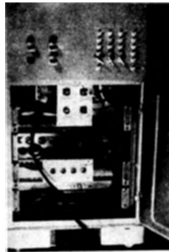
Рис. 13. Пульт управления и контроля.
