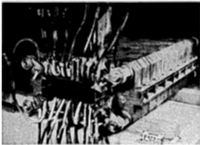
Рис. 1. Общий вид выводной линзы.
